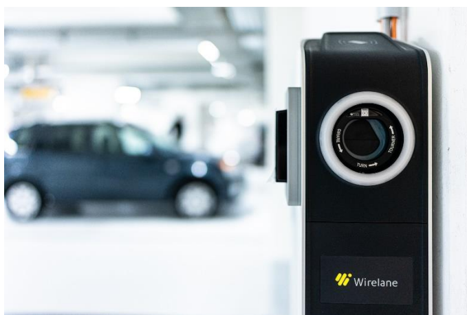
Bild 3: Light & Charge Ladesäule Wirelane
